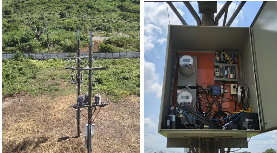
Imagen 3: Referencia de conexión y medición
