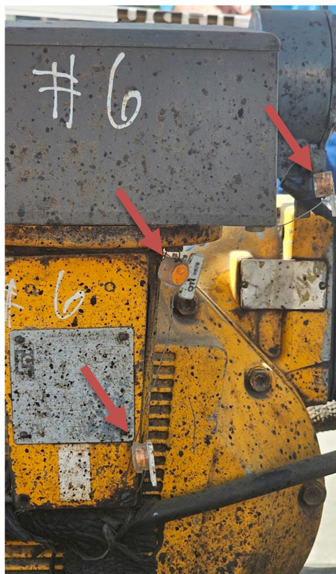
Imagen 10. Sellos del medidor de combustible.
