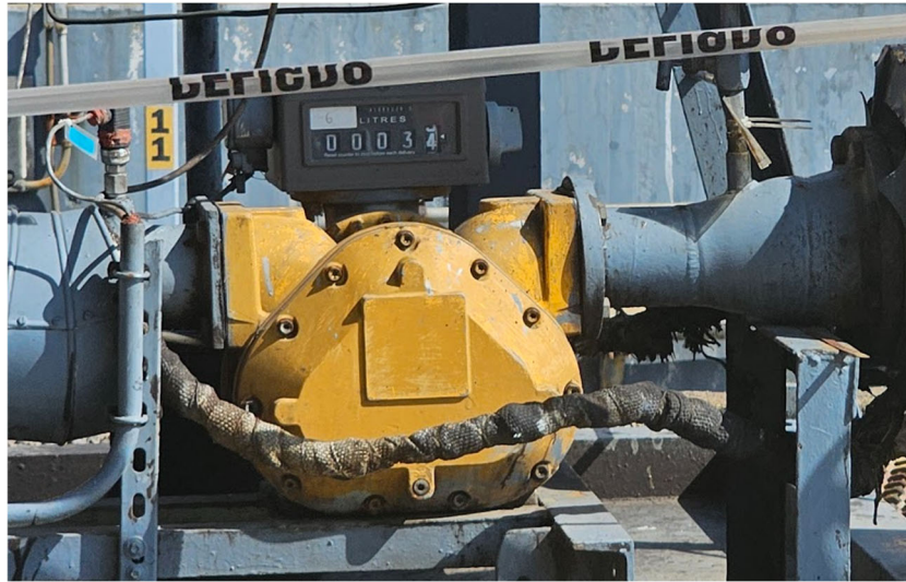
Imagen 8 Medidor de combustible del puerto de carga número 6.
