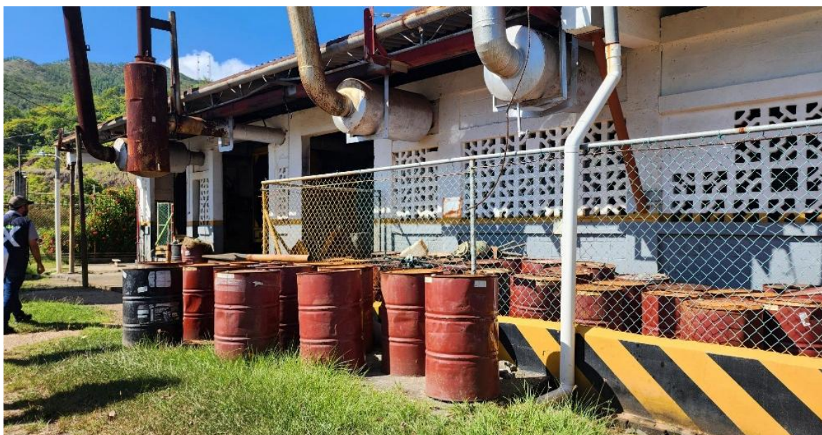
Imagen 8-4 Instalaciones de la central de generación de BELCO
