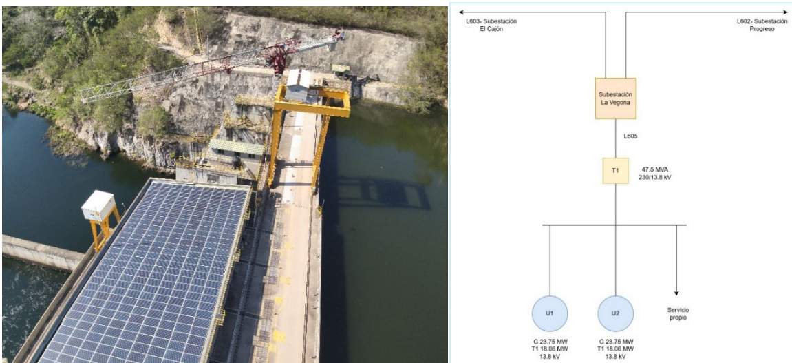
Imagen 9 Estructura de embalse y diagrama unifilar de la central generadora La Vegona (fuente: central La Vegona)
