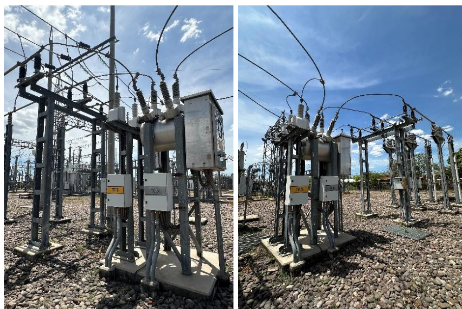
Imagen 41 Subestación Santa Lucía
