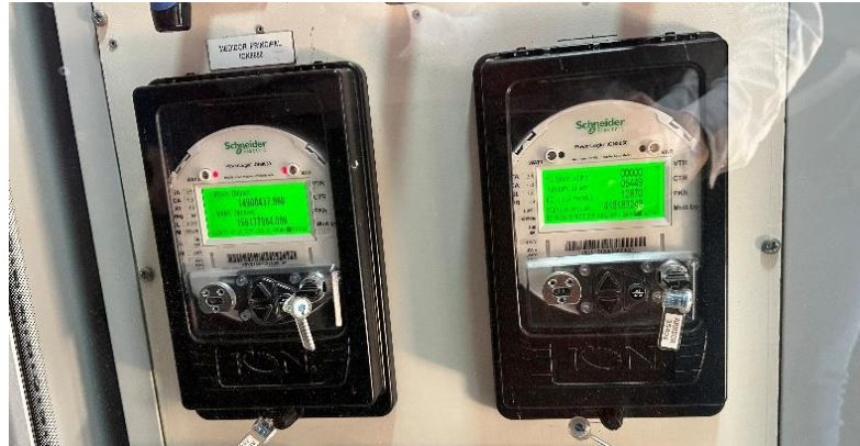
Imagen 25 Equipos de medición comercial instalados por el CND
