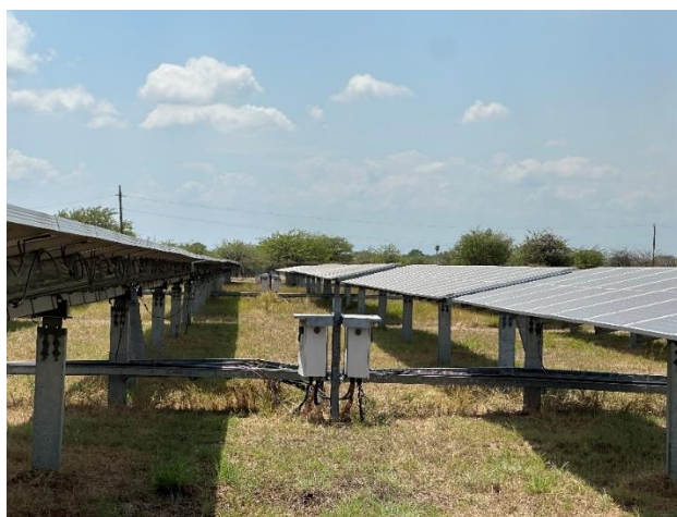
Imagen 30 Paneles solares de la central El Caguano
