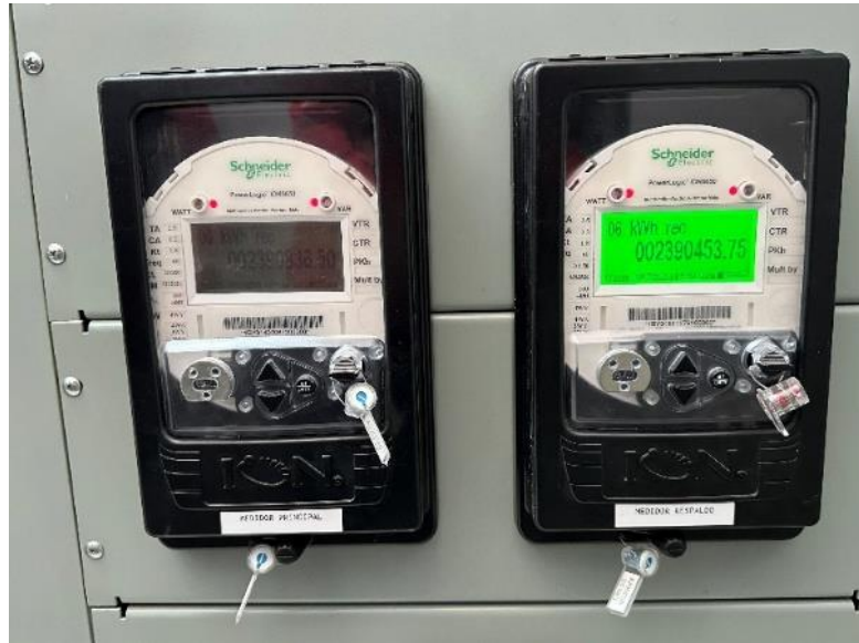
Imagen 43 Equipos de medición comercial instalados por el CND L356
