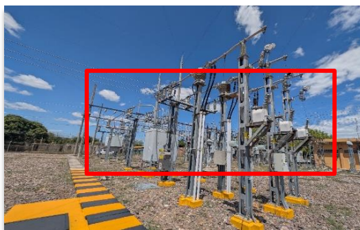
Imagen 23 Subestación Santa Lucía
