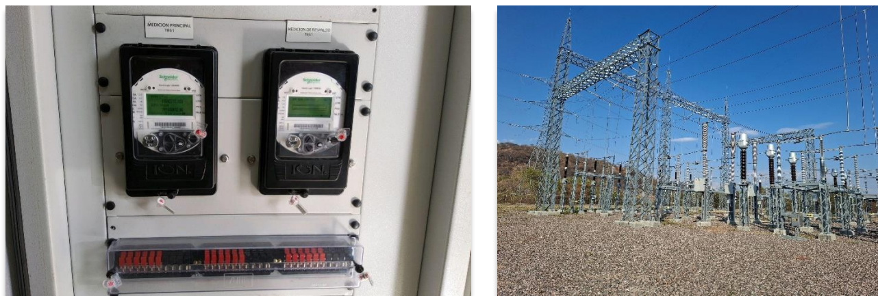
Imagen 12 Medidores de liquidación ubicados en la subestación
