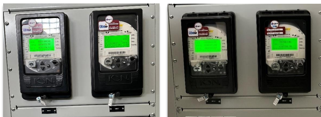
Imagen 38 Equipos de medición comercial instalados por el CND (izq) L353 (der) L354
