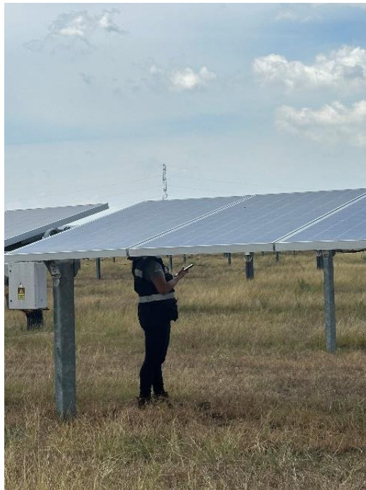
Imagen 35 Paneles solares de la central Choluteca I y Choluteca II
