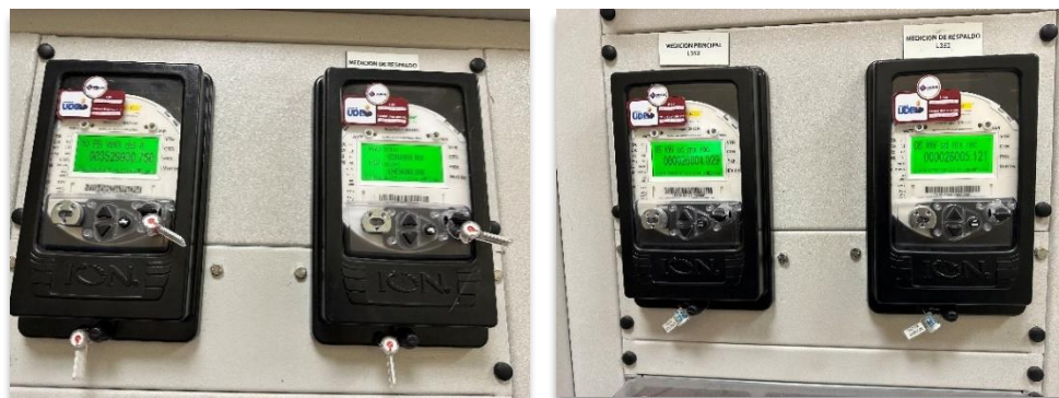
Imagen 33 Equipos de medición comercial instalados por el CND (izq) L349 (der) L352
