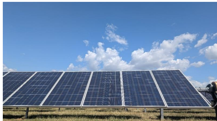
Imagen 27 Paneles solares de la central Pacífico I
