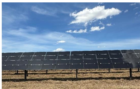
Imagen 40 Paneles solares de la central Solar del Sur
