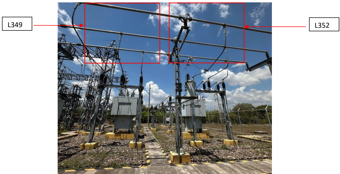
Imagen 31 Subestación Santa Lucía
