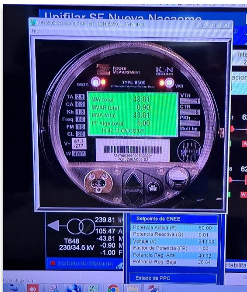
Imagen 5 Medición del Sistema SCADA
