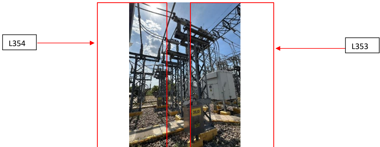
Imagen 36 Subestación Santa Lucía
