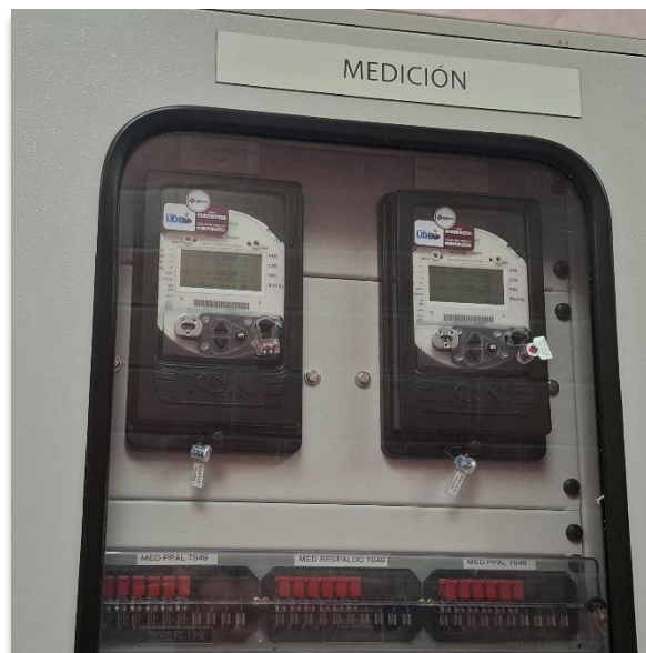
Imagen 6 Equipos de medición principal y de respaldo
