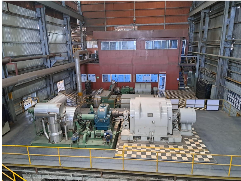
Figura 28 Equipo de generación.
