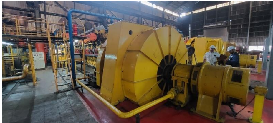
Figura 8 Instalaciones de la central generadora Ceiba Térmica.
