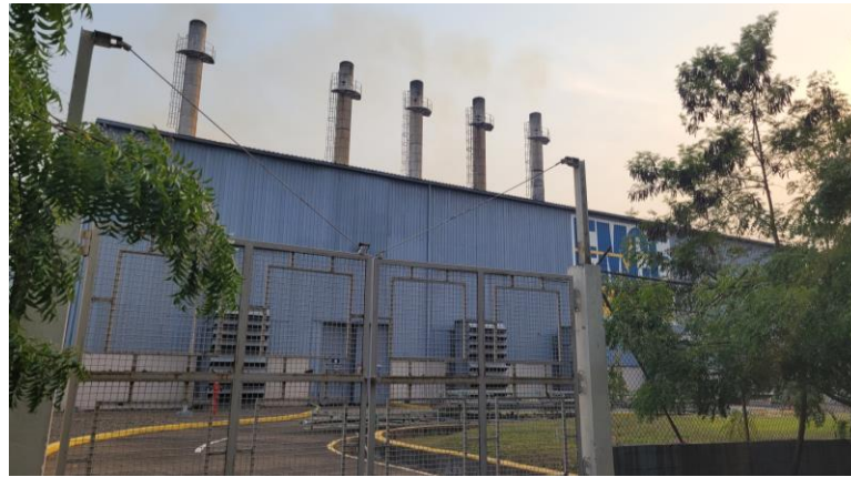
Figura 19 Instalaciones de la central térmica EMCE.
