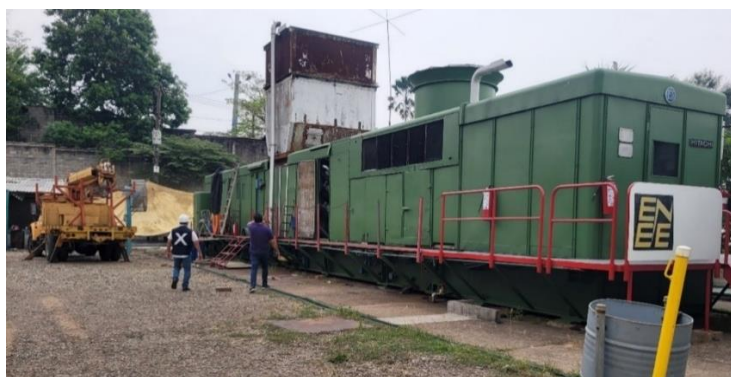
Figura 11 Unidad de generación Hitachi, central térmica La Puerta.
