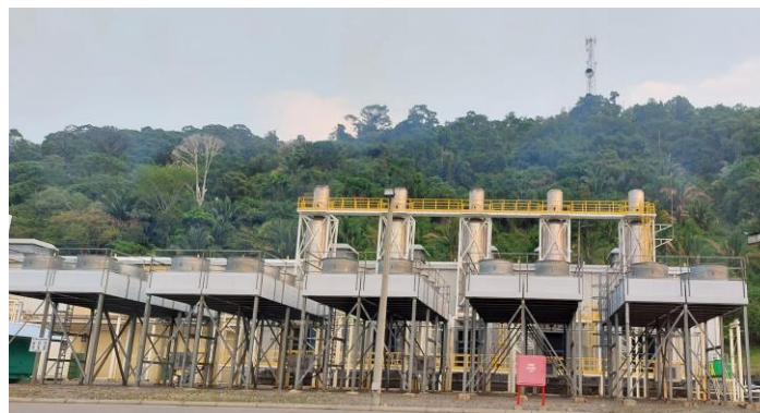
Figura 15 Instalaciones de la central térmica La Ensenada.
