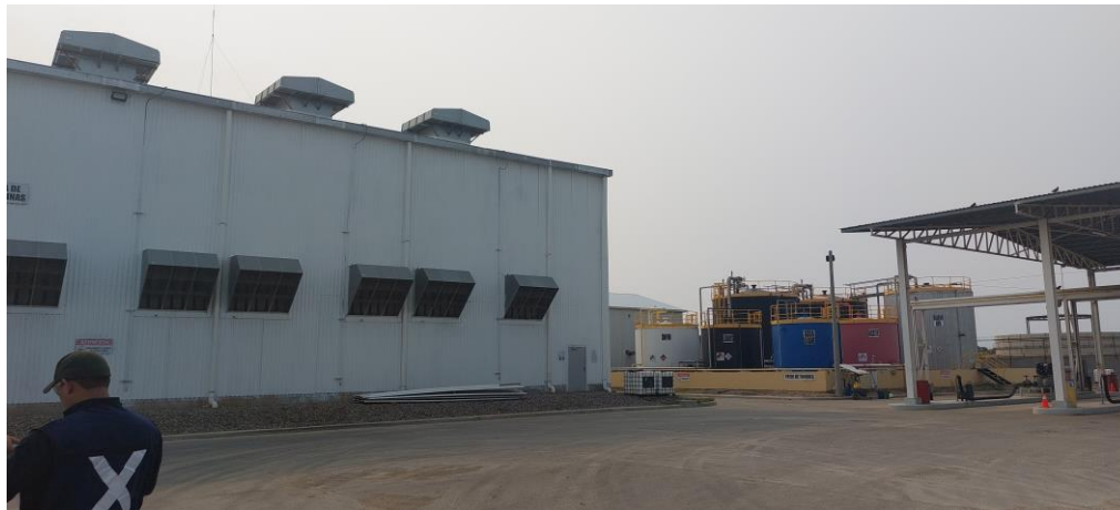
Figura 17 Instalaciones de la central térmica El Faro.
