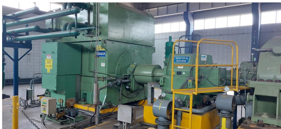
Figura 20 Instalaciones de la central generadora de biomasa Merendon Power Plant.
