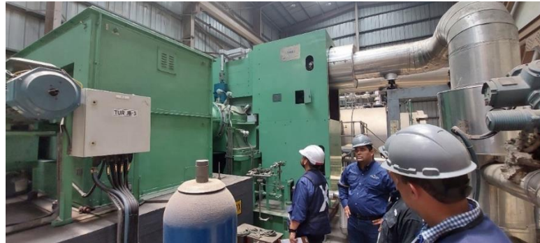
Figura 21 Instalaciones de la central generadora de biomasa Green Power Plant.
