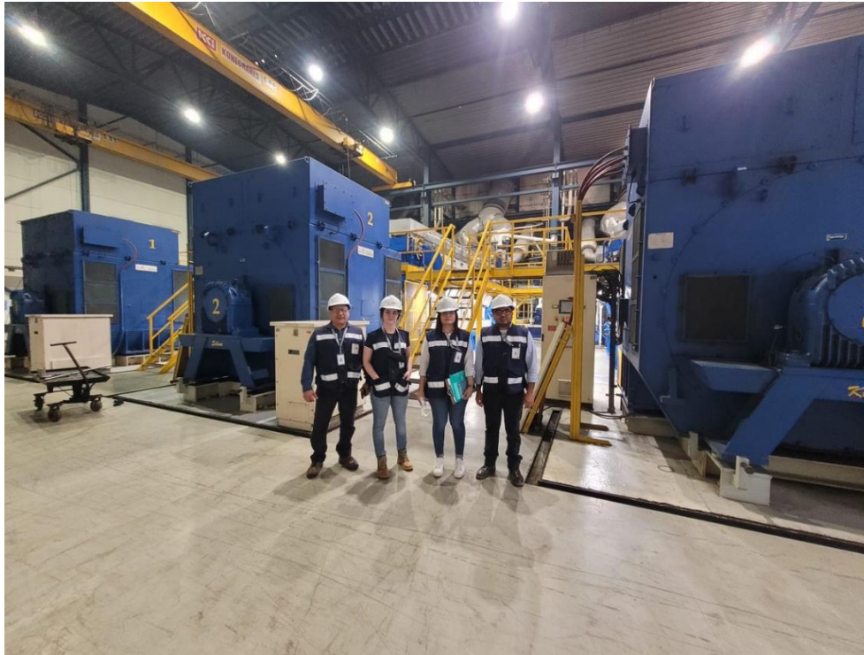
Figura 13: personal de la CREE junto a motores y generadores de las unidades 1,2 y 3, central térmica LUFUSSA II.
