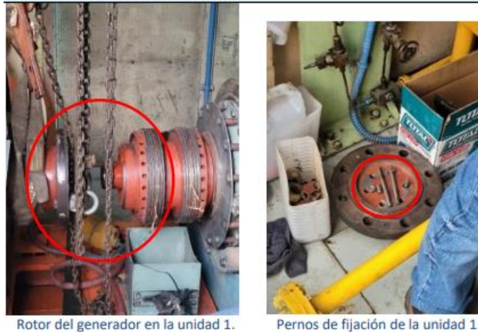
Figura 12: daño en el acople del excitador de la unidad Hitachi.
