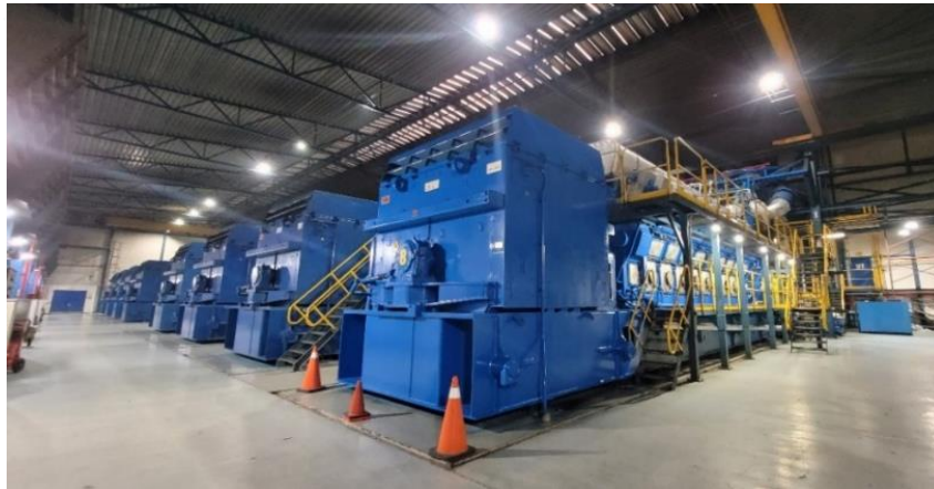
Figura 14 Instalaciones de la central térmica LUFUSSA III.
