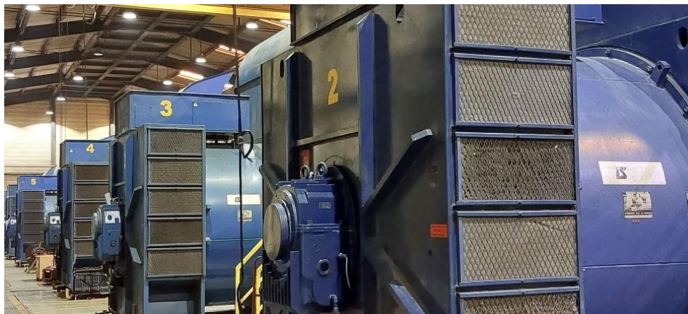
Figura 16 Instalaciones de la central térmica ELCOSA.
