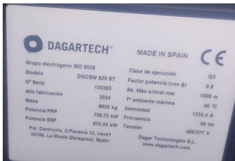
Imagen 20 Datos de placa del grupo electrógeno #4
