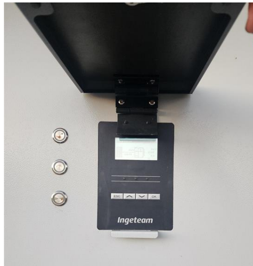
Imagen 10 Inversor Fase II (Fuente: propia)
