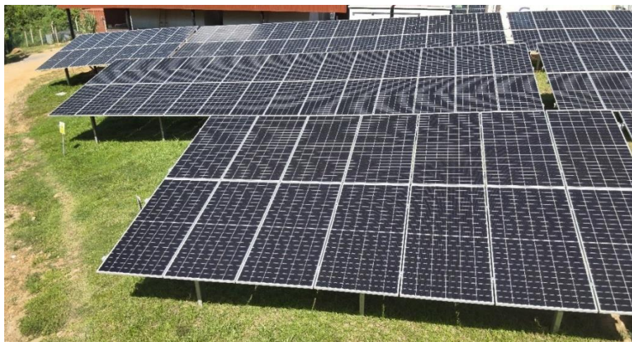
Imagen 2 Paneles solares en proyecto PERLA Fase I (Fuente: propia)
