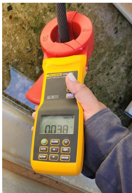
Imagen 29 Medición de tierra en transformador de potencia Fase I
