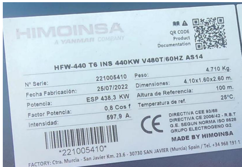
Imagen 18 Datos de placa del grupo electrógeno #3
