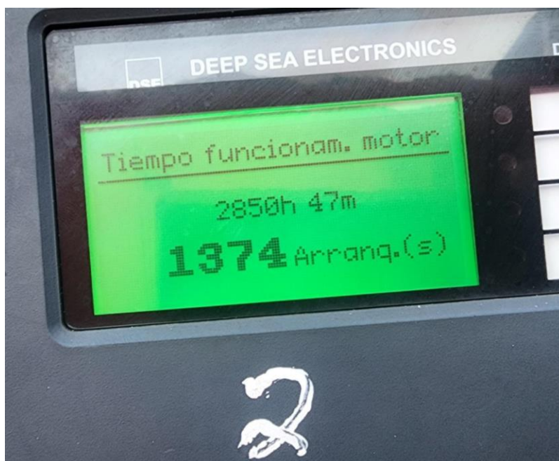
Imagen 15 Pantalla del grupo electrógeno #2
