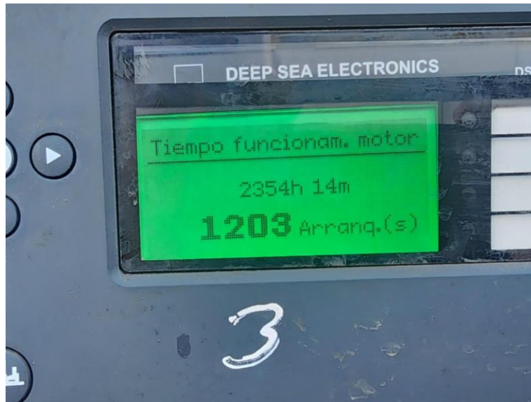
Imagen 17 Pantalla del grupo electrógeno #3
