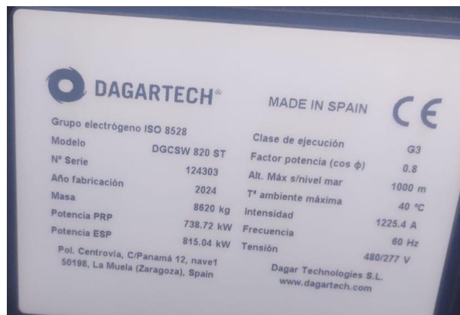
Imagen 22 Datos de placa del grupo electrógeno #5
