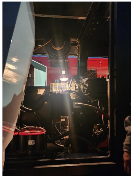
Imagen 23 Interior del grupo electrógeno #5
