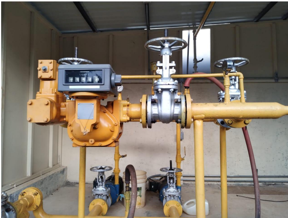
Imagen 32 Medidor de combustible
