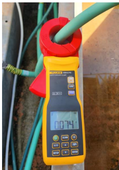
Imagen 28 Medición de tierra en transformador de potencia Fase I
