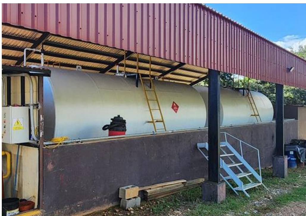
Imagen 31 Tanques de almacenamiento de combustible
