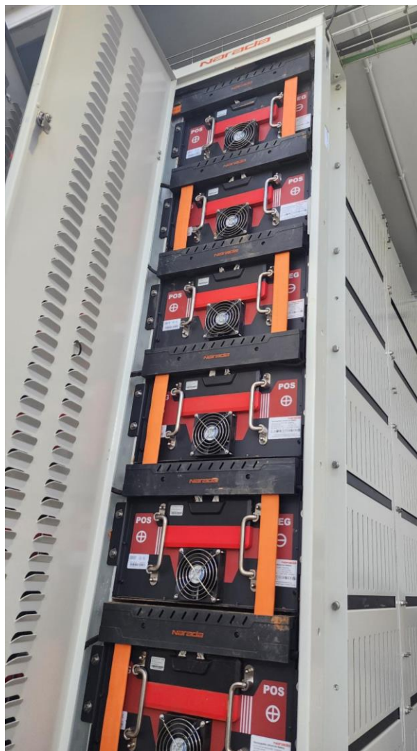
Imagen 24 Rack de baterías de litio NARADA
