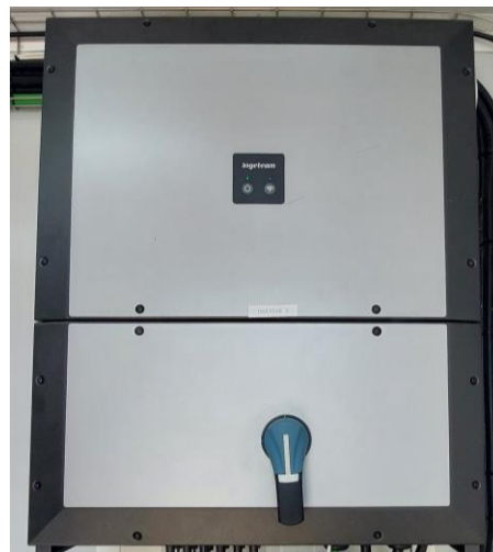
Imagen 5 Inversor Fase I (Fuente: propia)
