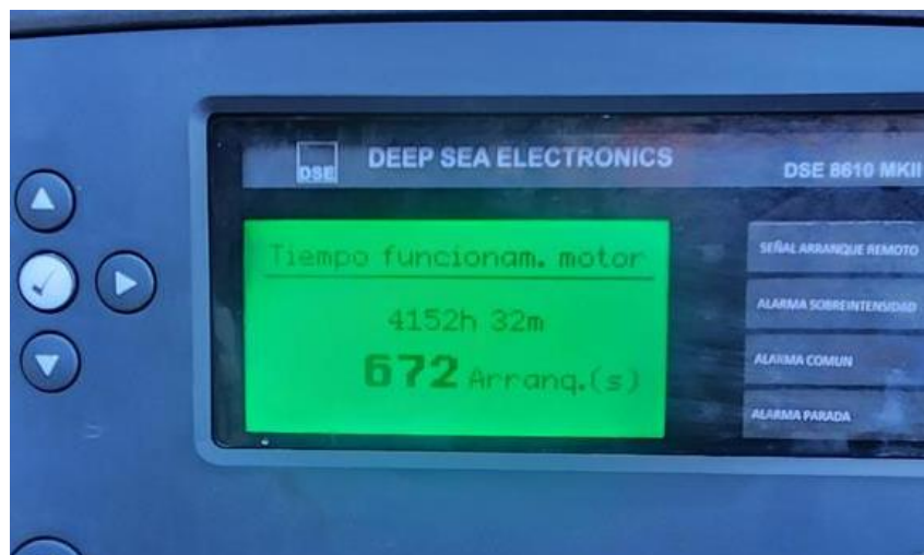
Imagen 19 Pantalla del grupo electrógeno #4
