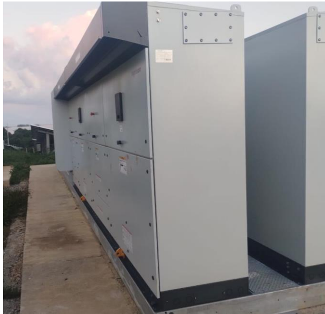
Imagen 25 Inversor banco de baterías Fase II
