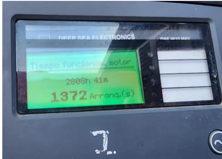
Imagen 13 Pantalla del grupo electrógeno #1
