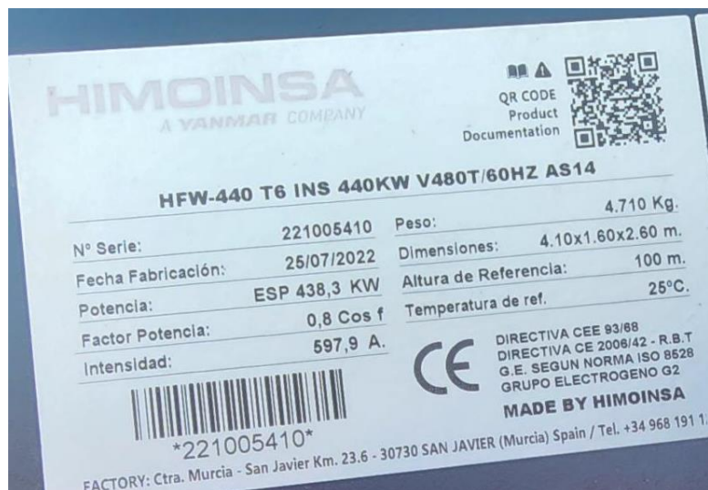
Imagen 14 Datos de placa del grupo electrógeno #1
