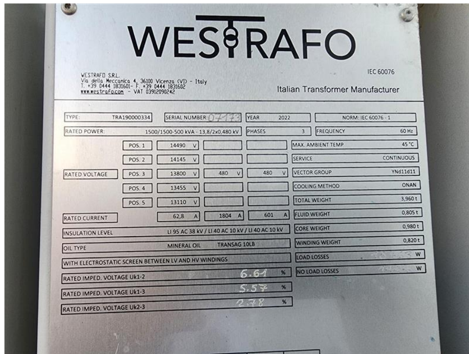
Imagen 26 Datos de placa del transformador de potencia Fase I
