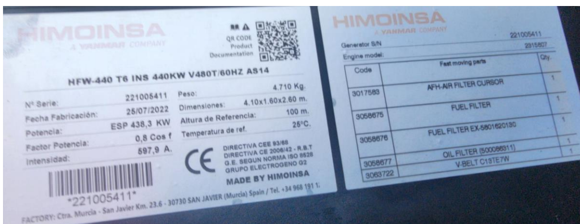
Imagen 16 Datos de placa del grupo electrógeno #2
