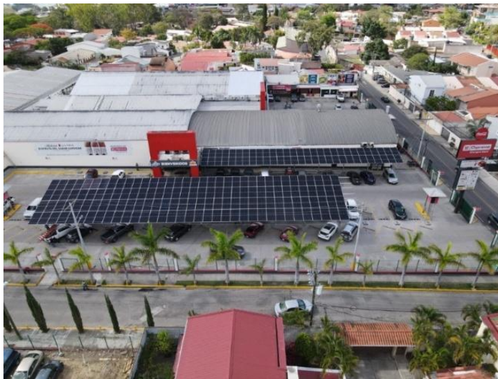
Imagen 8 Módulos fotovoltaicos DIPROVA (fuente: propia)
