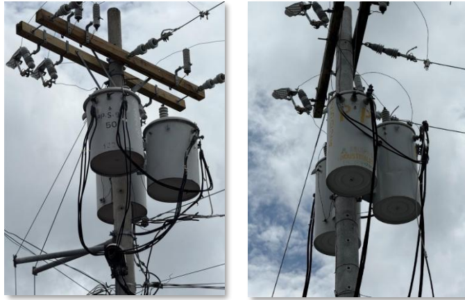
Imagen 6 Banco de transformadores DIPROVA (fuente: propia)
