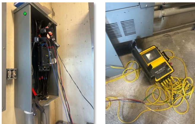
Imagen 12 Instalación de analizadores segunda sesión ENEE (fuente: propia)
