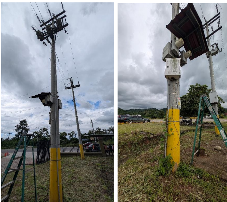
Imagen 10 Equipos de medición del punto T537_3064_101M1/M2
