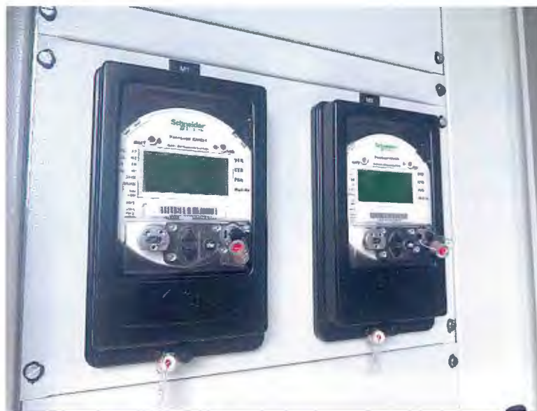
Imagen 5 Equipos de medición comercial instalados por el CND
