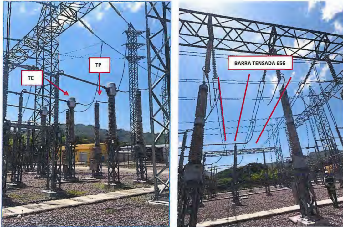
Imagen 9 Punto de conexión y medición, con transformadores de corriente y potencial a la izquierda y barra tensada 656 a la derecha.
