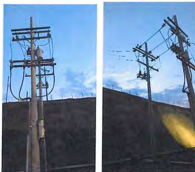
Imagen 45 red eléctrica de la empresa Minosa
