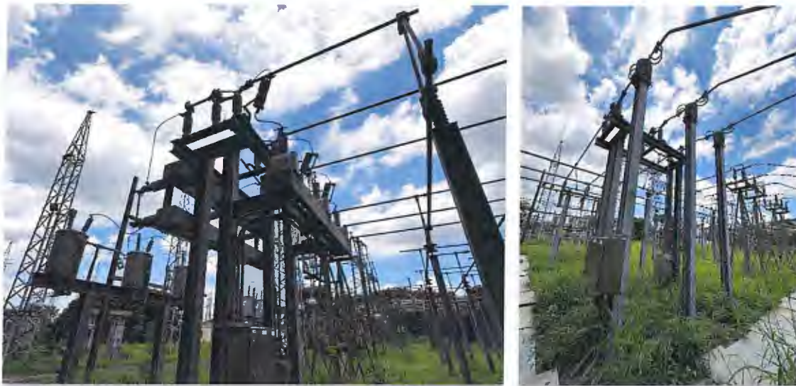
Imagen 3 Punto de Conexión y Medición (izq) Transformadores de potencial (der) Transformadores de corriente
