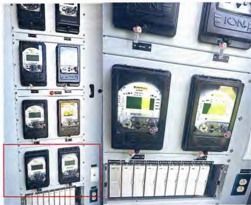
Imagen 19 Equipos de medición comercial instalados por el CND donde se registra de manera independiente la medición de Fotovoltaica Sureña
