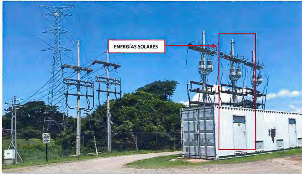
Imagen 8 Líneas en doble terna que se dirigen a la subestación Los Prados
