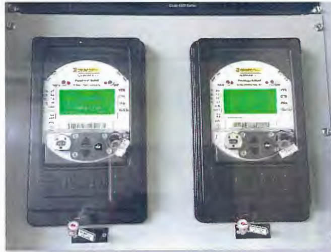
Imagen 11 Equipos de medición comercial instalados por el CND donde se registra consumo de los tres proyectos
