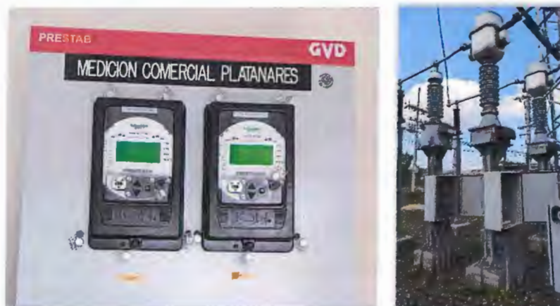
Imagen 42 Equipos de medición principal y de respaldo ubicados en la Subestación Santa Rosa
