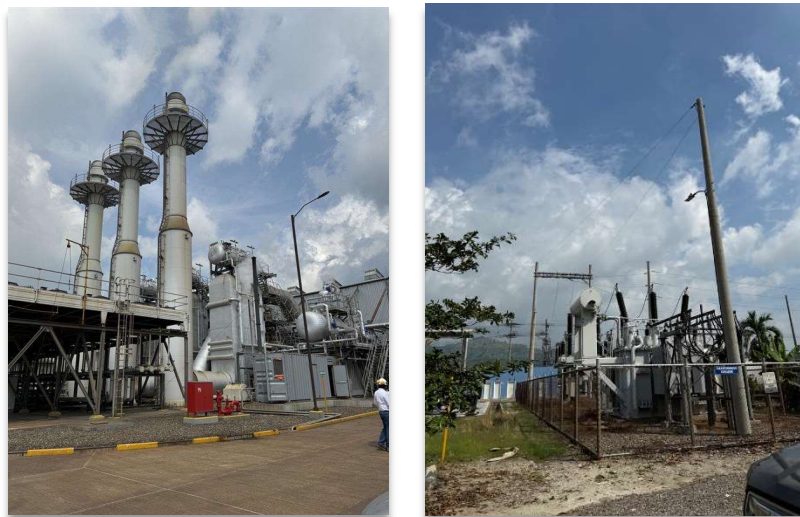
Imagen 28 Central generadora PECSA (fuente: propia)
