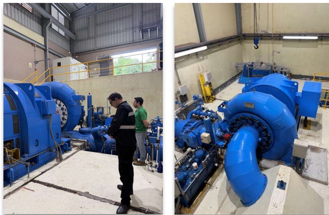
Imagen 32 Central hidroeléctrica Rio Blanco (fuente: propia)
