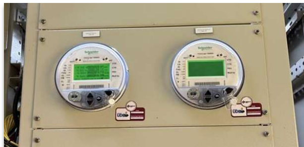
Imagen 27 Punto de medición central generadora CEPCO (fuente: propia)
