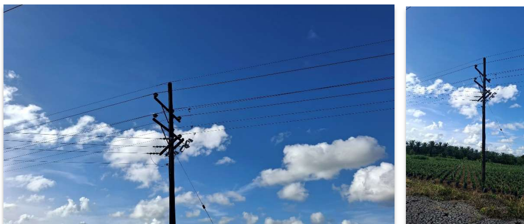
Imagen 11 Punto de conexión
