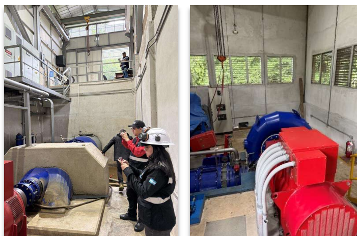
Imagen 30 Central generadora Peña Blanca (fuente: propia)
