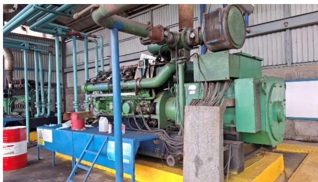
Imagen 10 Unidad de generación
