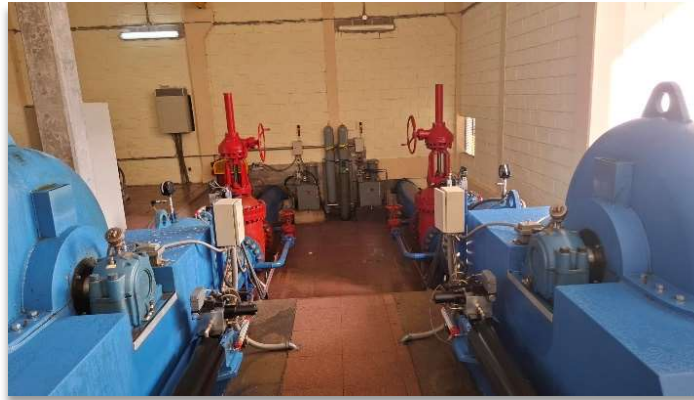
Imagen 21 Unidades generadoras de la central hidroeléctrica Coronado
