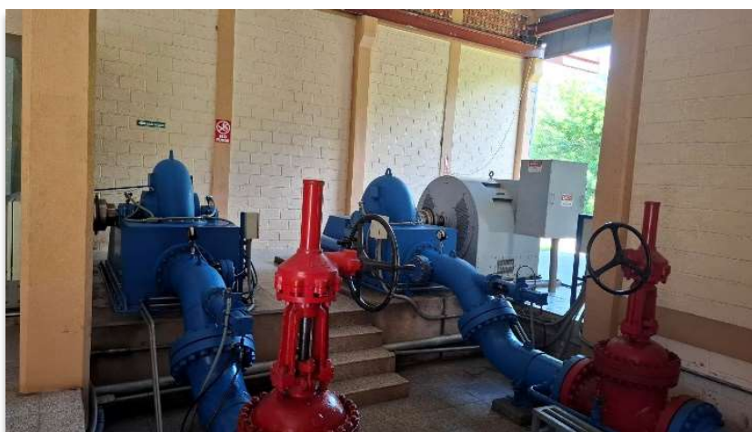
Imagen 20 Unidades generadoras de la central hidroeléctrica Babilonia
