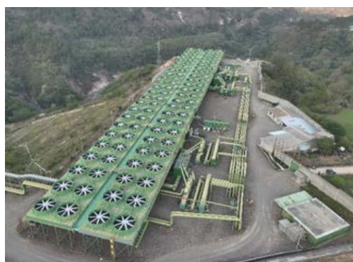
Imagen 1 Lectura de orden de inspección GEOPLATANARES e instalaciones de la central generadora
