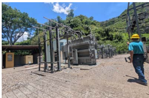
Imagen 3 Verificación de los puntos de conexión de la central hidroeléctrica Nispero II
